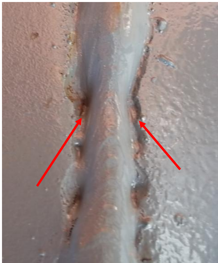
Figura 14: Trinca de Solda
