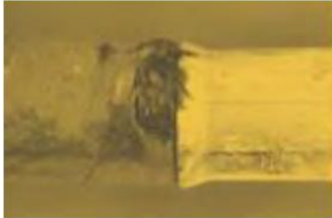
Figura 22: Falha por desprendimento da mangueira do seu acoplamento.
