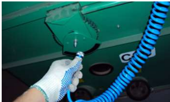
Figura 18: Pormenor do local de acoplamento da mangueira de ar
