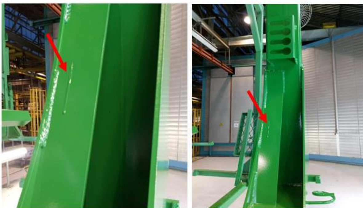
Figura 14 - Escorrimento de tinta
