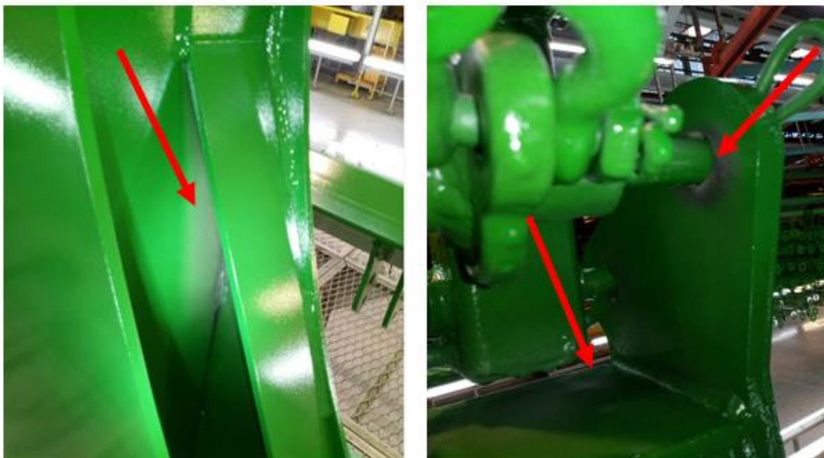
Figura 12 - Locais da lança com a falta de tinta
